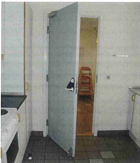
Her ses branddøren til køkkenet i et Fælleshus. Her ses dørpumpen, der er tænkt til at sikre at døren altid holdes lukket, så en brand i køkkenet ikke umiddelbart vil sprede sig til hele fælleshuset. I bunden af døren ses dog også et eftermonteret beslag til at fastholde døren åben...så er man jo lige vidt sikkerhedsmæssigt. Foto: Nordjyllands Beredskab
