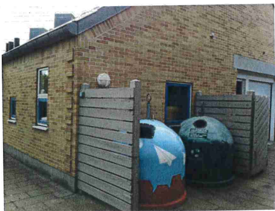
En påsat brand i disse containere vil med overvejende sandsynlighed føre til brandspredning til den tilstødende bygning. Foto: Nordjyllands Beredskab
