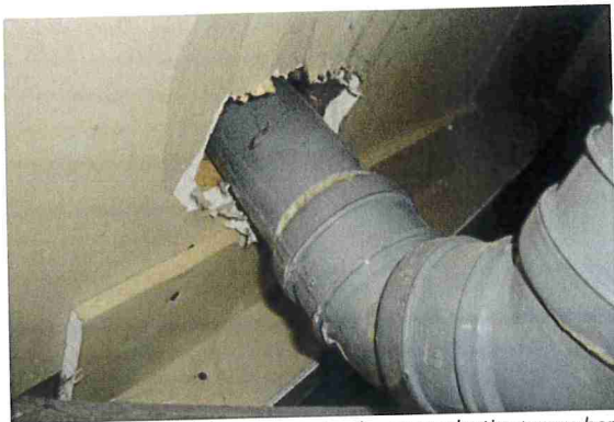
Når en gipskonstruktion gennembrydes og et plasticør som her føres igennem, fjernes den brandbeskyttende effekt.
