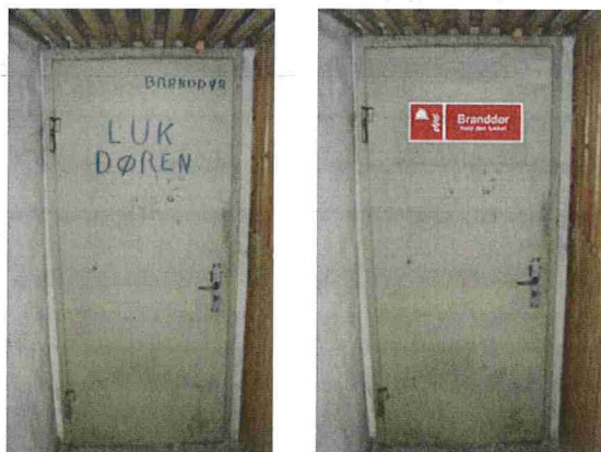
Denne branddørs lukkefunktion i hængslet virkede heller ikke. Men til gengæld er der, som vist på fotoet til venstre, informeret tydeligt til beboerne om, at døren har en brandmæssig betydning og at den skal holdes lukket. På det manipulerede foto til højre er det vist hvorledes det mere "officielt" kan skiltes med et "Sikkerhedsskilt".
